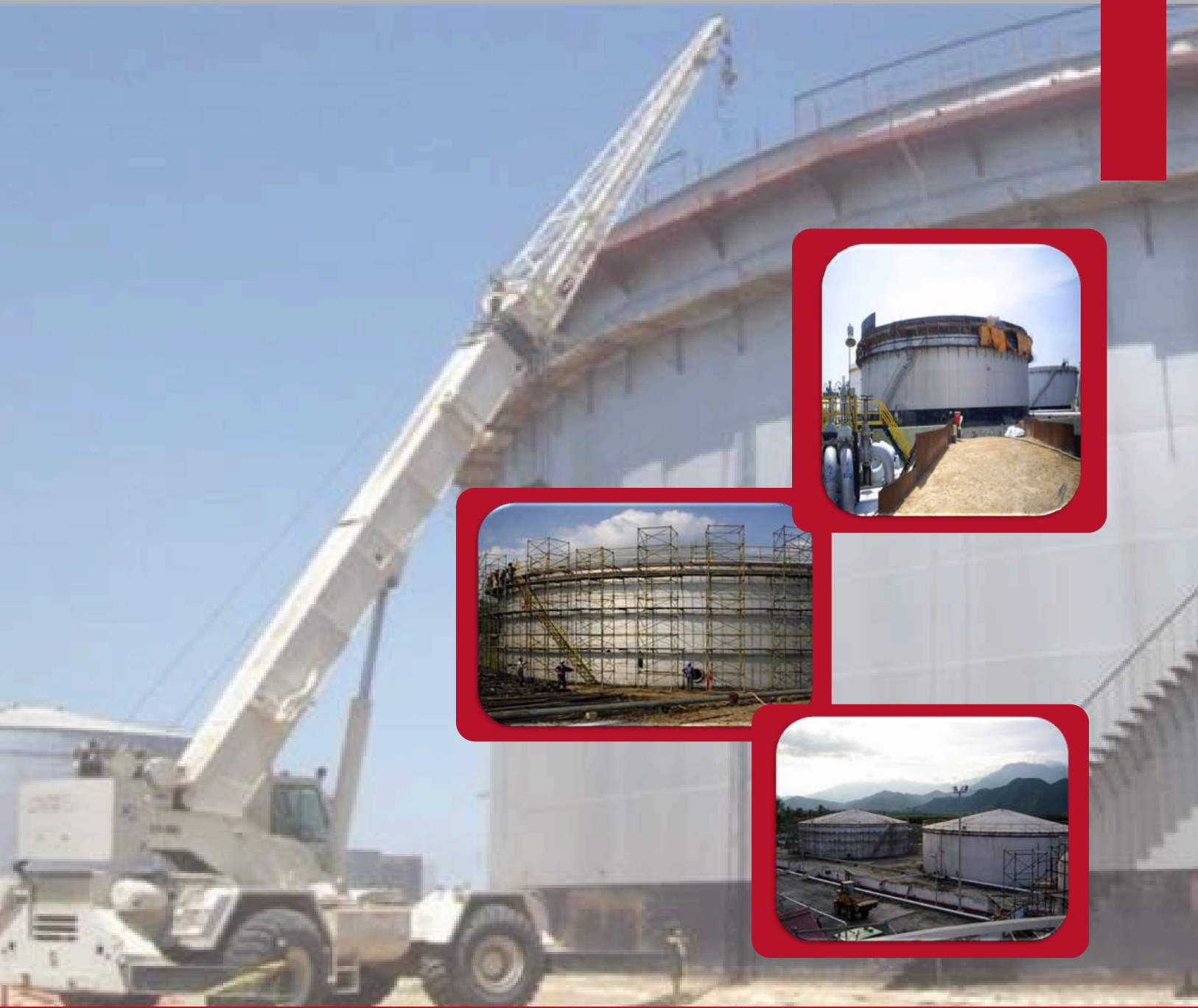
TANQUES REFINERÍA EL CARDÓN
